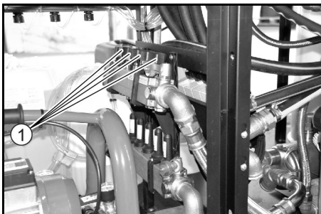
① Válvula de cierre de la calefacción de estación de lavado
