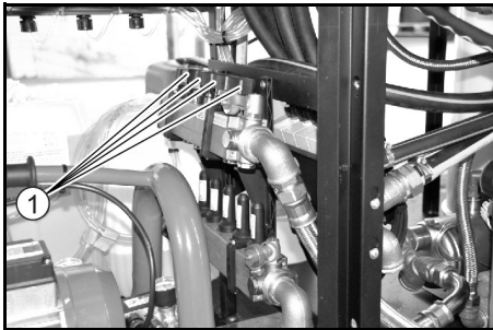
① Avstängningsventil tvättplatsuppvärmning
