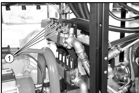
① Afsluitventiel wasplaatsverwarming
