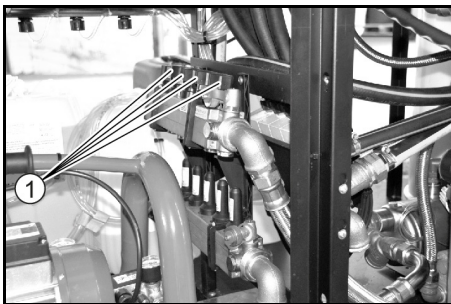
① Absperrventil Waschplatzheizung
