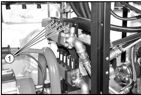
① Valvola di intercettazione riscaldamento della postazione di lavaggio
